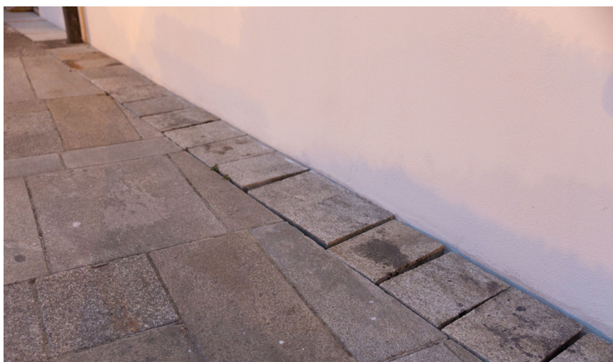
Sumidoiro lineal de augas pluviais en, Santiago de Compostela.
