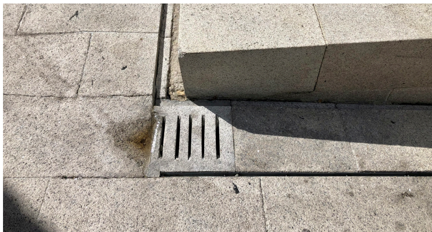
Sumidoiro puntual para recoller as augas da canalización aberta e sumidoiro lineal soterrado no casco histórico de Lugo.
