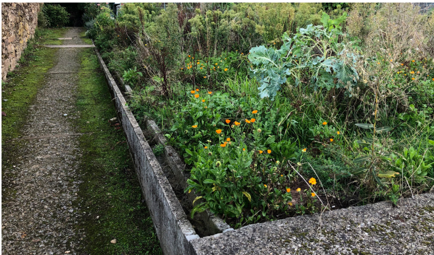
Canalización aberta para as augas pluviais e augas de regadío nas hortas de Caramoniña en Santiago de Compostela.
