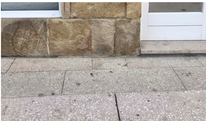
Unión entre lousas de granito con fachada en Porto do Son, A Coruña.
