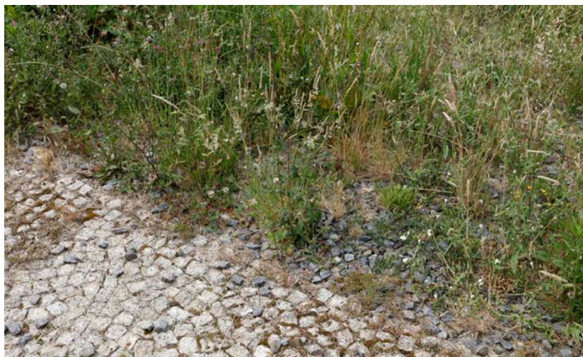
Dispersión dos adoquíns de granito promovendo o crecemento de vexetación entre as xuntas no Centro Social de Oleiros, Ribeira, A Coruña.
