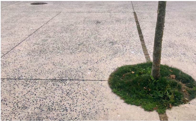
Unión entre pavimento de formigón con árido visto e foso para árbore en Porto do Son, A Coruña.
