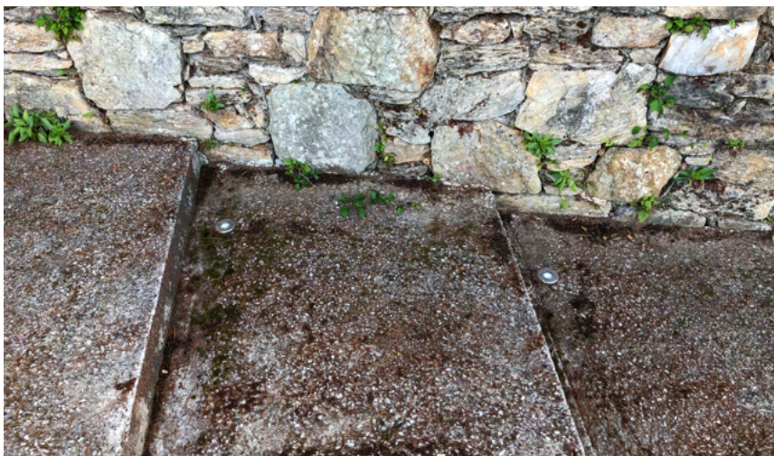
Iluminación no plano do chan, situado nas escaleiras das hortas de Caramoniña en Santiago de Compostela.
