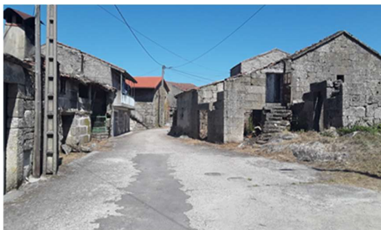
Representación do abandono das edificacións.
